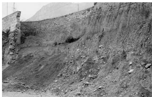
Fig. 10. 1957 - Crollo parziale del muro di sostegno del campo di calcio.
