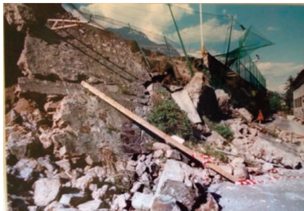
Fig. 9. 1996 - Crollo di parte del muro di sostegno del campo di calcio.
