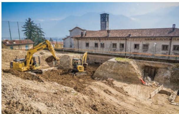
Fig. 13. Tecnica di scavo per salvaguardare l'integrità del muro di sostegno del campo di calcio dell'Oratorio (Foto D. Bassanesi).
