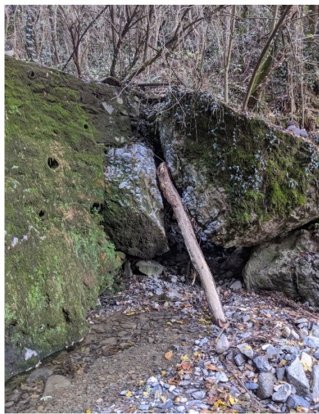
Figura 15: Erosione muro briglia D
